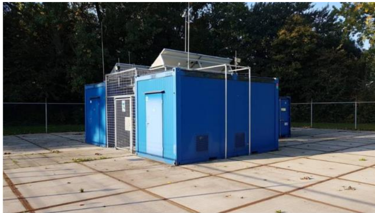
Electrolyse unit bij flatgebouw.
